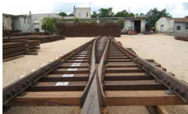
▲ Photo 68 : Traverses d'une ligne d'aiguillage © WIJMA
