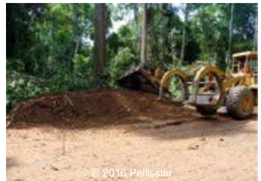
© 2016 Pellissier Compactage à la fourchette, et fermeture du dépôt de terre végétale (arrière plan)
